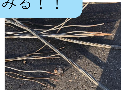
錆びていたケーブル
